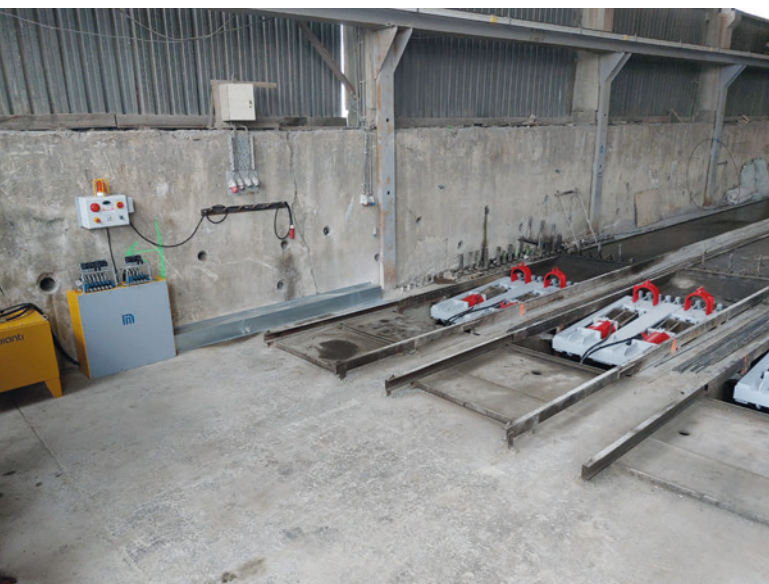
Groupe hydraulique de relâchement des fils installé à côté des bancs de production
